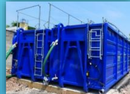
AVC và Bể đệm AVC and Buffer Tank
