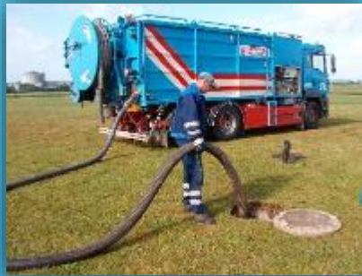
Bể tự hoại Septic tanks
