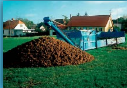
Máy trộn bùn và vôi Sludge and lime mixer
